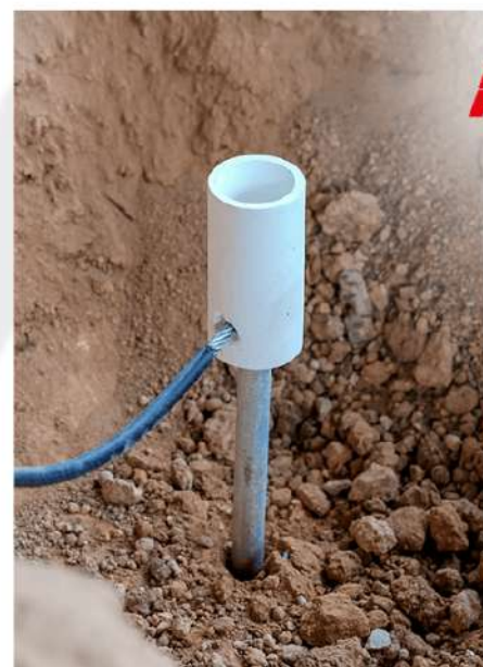
SISTEMAS DE ATERRAMENTO
