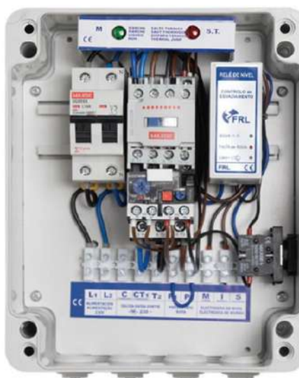
QUADRO MEDIDOR E DE DISTRIBUIÇÃO
