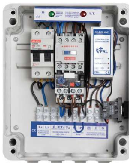
QUADRO MEDIDOR E DE DISTRIBUIÇÃO
